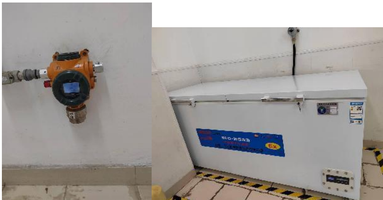
F6.26-1 综合车间可燃气体探测器已通电使用，冰柜改为防爆型
