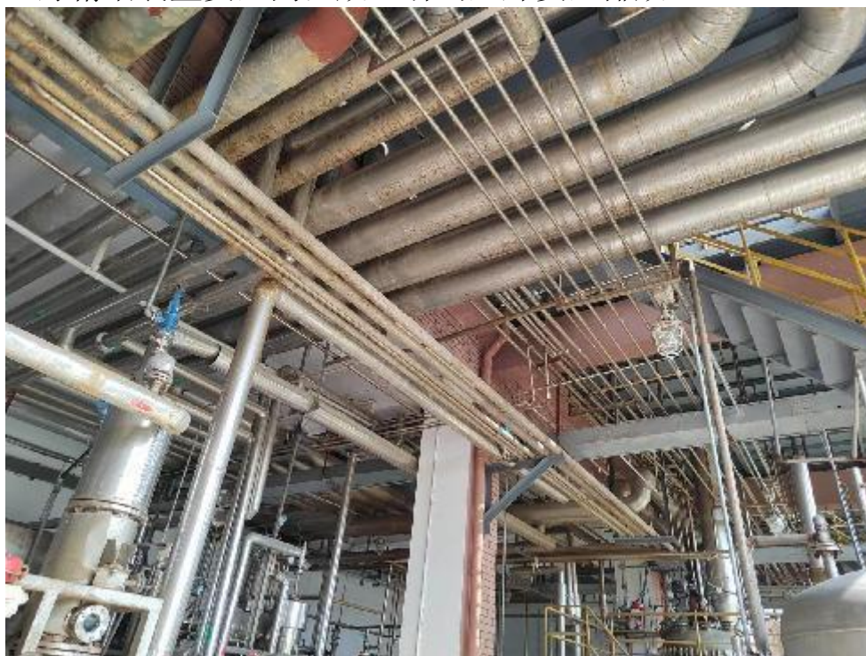
F6. 26-11 乙醇精馏装置安全阀泄放已引出室外安全排放
