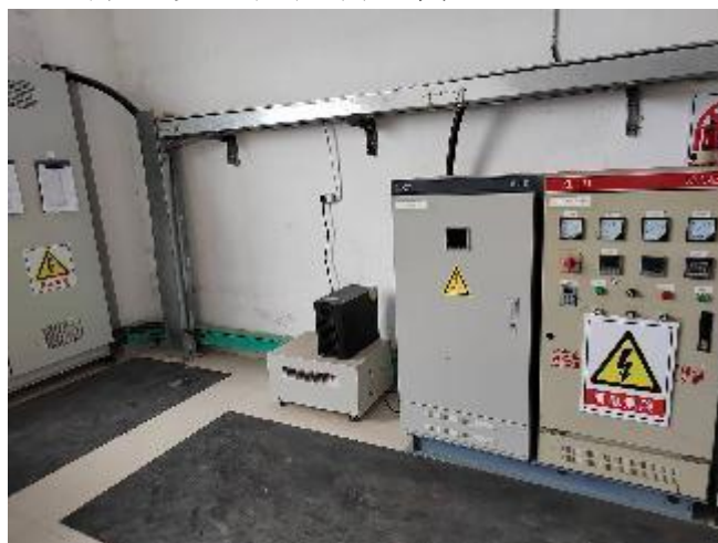
F6. 26-18GDS 的 UPS 电源已设置在控制室内
