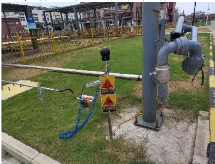
F6. 26-13 乙醇罐区卸车鹤管处已安装可燃气体检测仪
