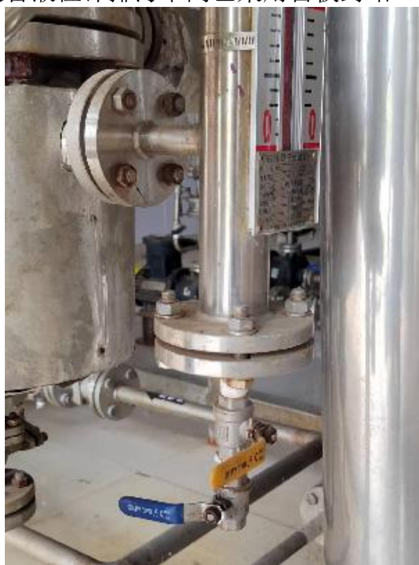
F6. 26-12 丙酮精馏设备液位计排污单阀已采用盲板封堵
