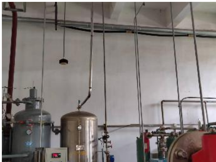
F6. 26-17 氮气储罐安全阀排放口在室内
