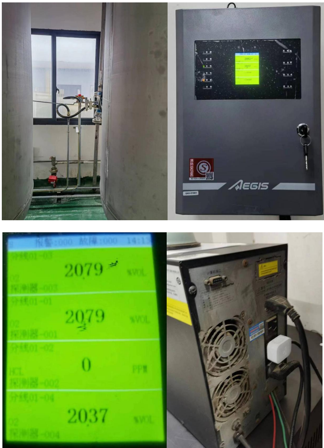
现场照片 7：氧气检测装置安装位置及 GDS 报警控制柜。
