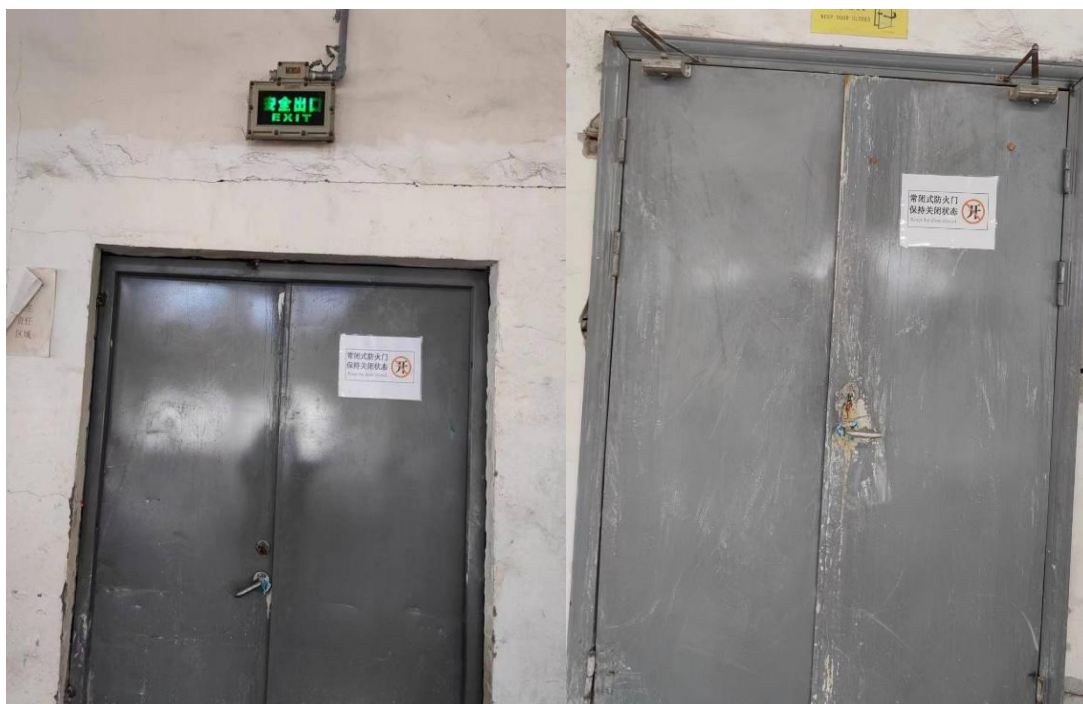
现场照片 12：车间一（一、二层）防火门为已设置为常闭
