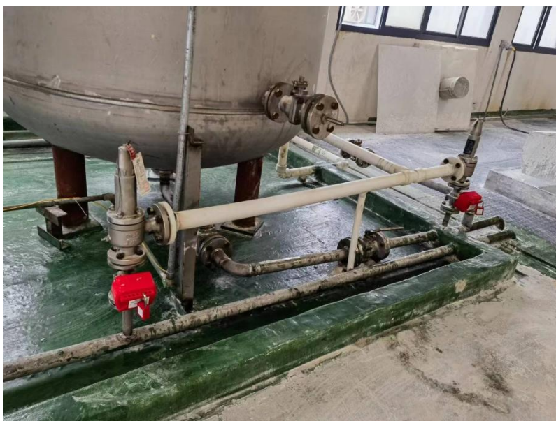
现场照片 3：双氧水管线安全阀根部阀已设置铅封
