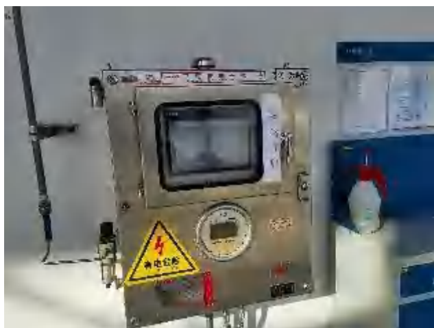
F6.32-5 风机成套控制柜已处理，能有效形成正压风机
