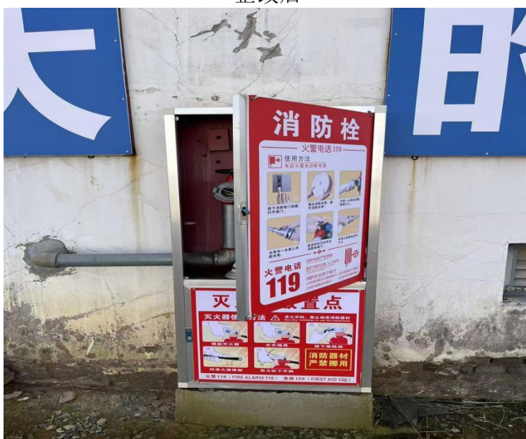
2只消防栓已进行防冻保温
